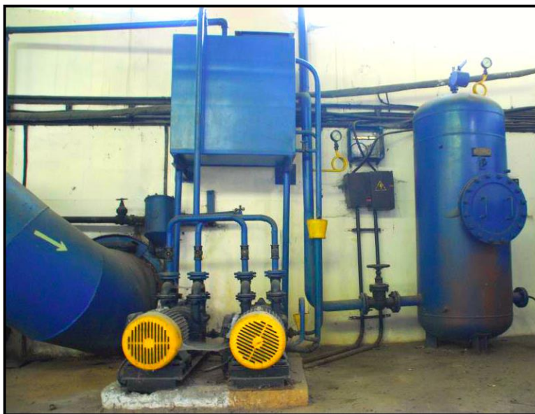
Stația de pompare – instalația de vid
