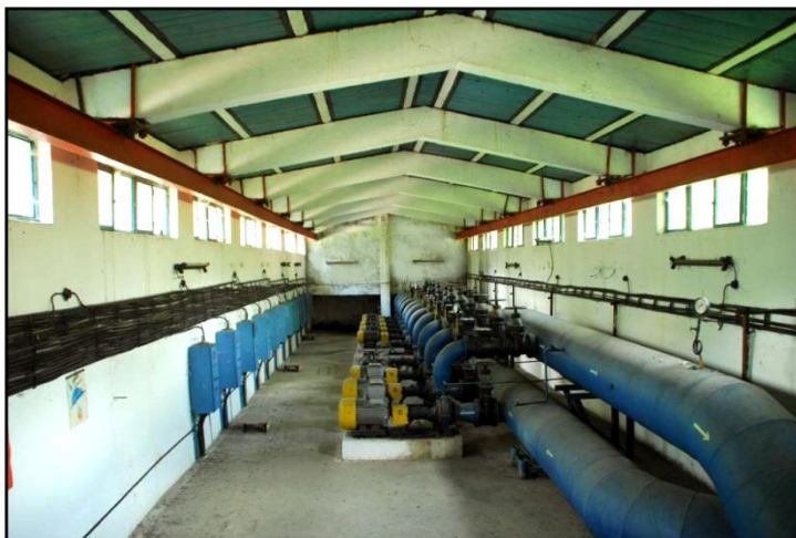
Sursa Moldovenești – Stația de pompare
