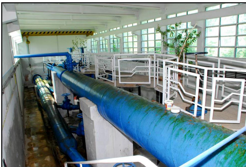
Stația de pompare Mihai Viteazu – Instalația hidraulică
